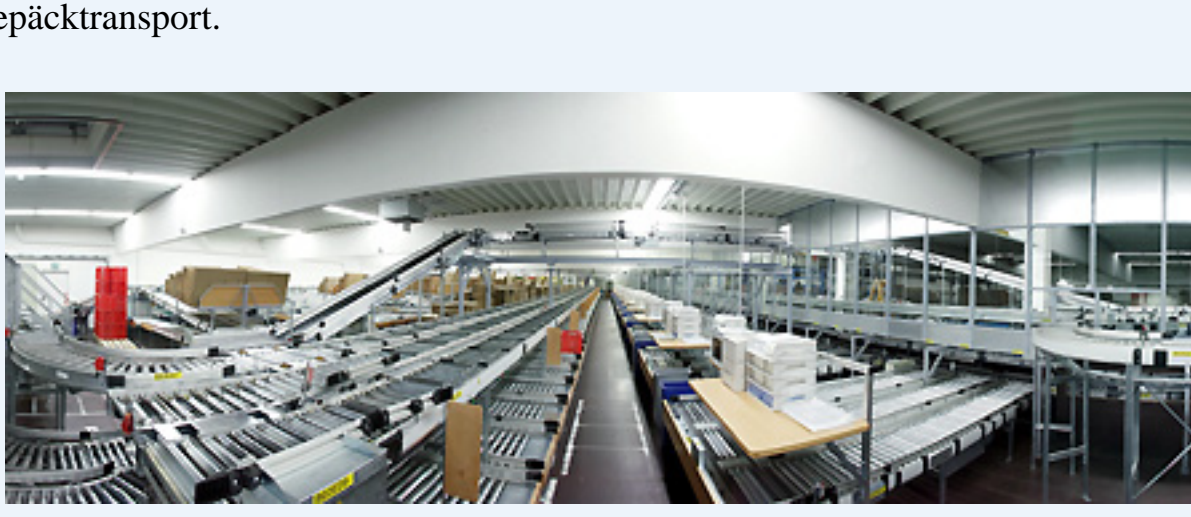
Ein komplettes Distributionszentrum mit allen erforderlichen Systemen gehört zum Leistungsspektrum.]
