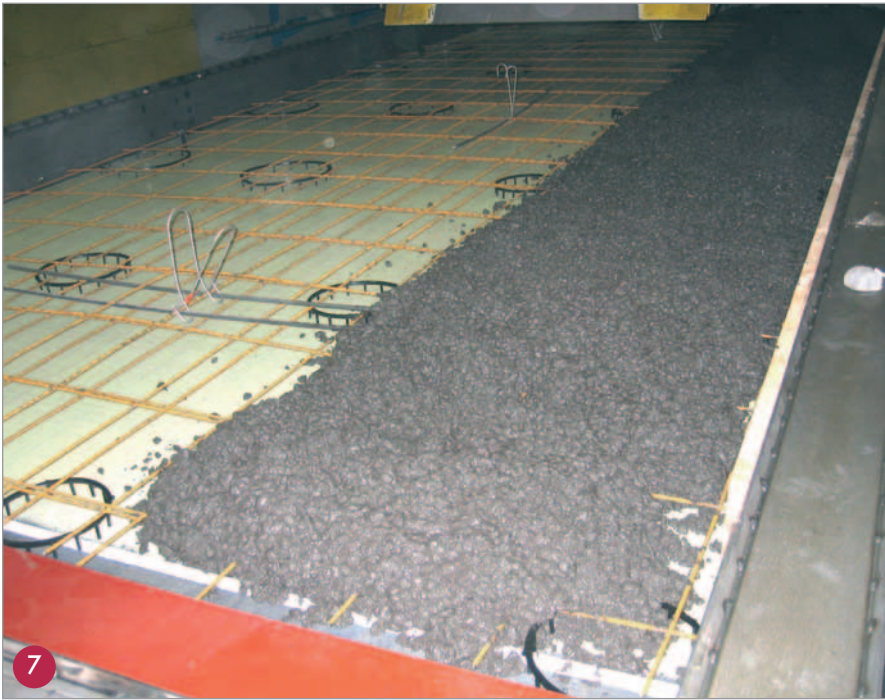
Einlegen der Bewehrung für Vorsatzbeton, Betonieren der Sichtbetonfläche mit Vorsatzbeton und anschließendes Verdichten mittels geräuscharmer Schütteltechnik.
