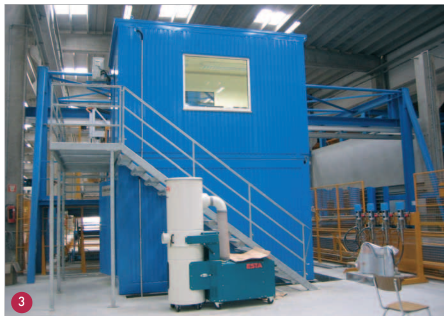
Leitstand und Leitreechner befinden sich im oberen Container, der Schaltschrankraum für die Umlauf- und Maschinensteuerung im unteren Container
