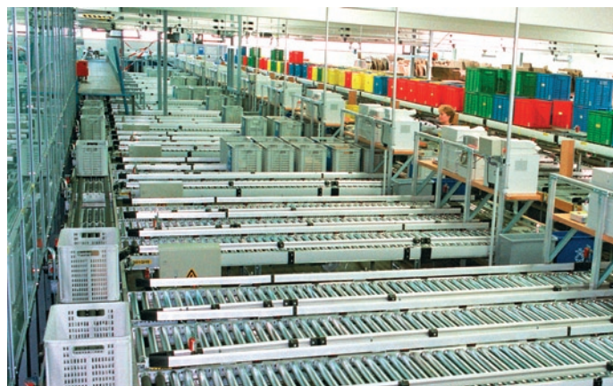
Bild 2: Kommissionierzone des 2004 als Generalunternehmer realisierten Logistikzentrums für das Unternehmen Soft-Carrier
