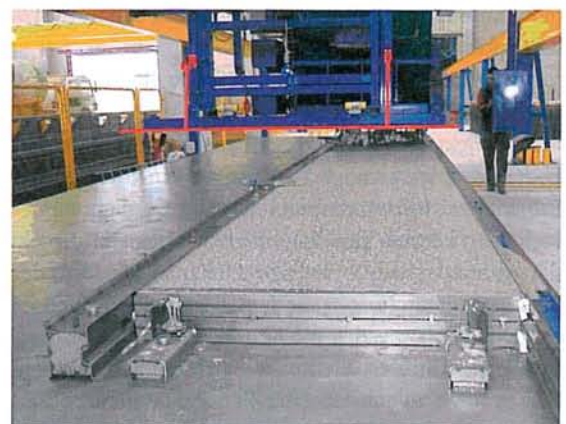
Fig. 2 Concreting of solid wall elements with joint profiles, shuttering positioned by shuttering robot. Abb. 2 Betonieren von massiven Wandelementen mit Vergussfugenprofilierung eingeschalt durch Schalungsroboter.
