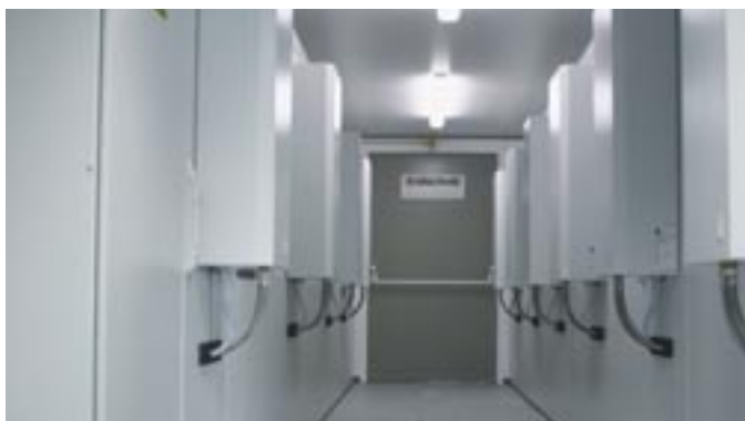
Die Rittal Komplettlösung reichte vom Schaltschrank über die Stromverteilung bis hin zur Rückkühlung und erwies sich als restlos überzeugend.
