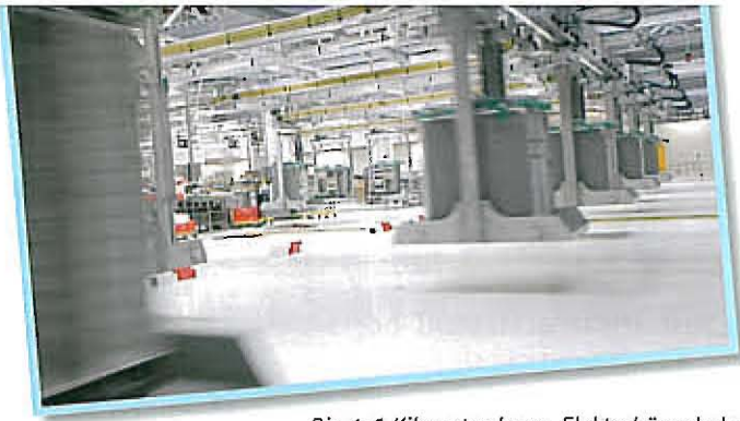
Die 1,6 Kilometer lange Elektrohängebahn ist das Rückgrat des Catering-Betriebs.
