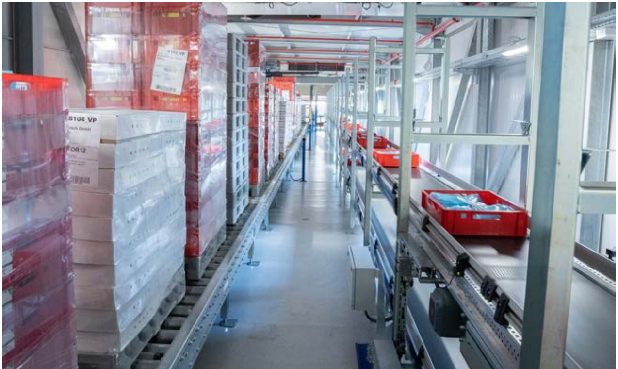
Über eine stählerne Brücke gelangen Paletten, Kisten und Kartons automatisch ins neue Logistikzentrum.
