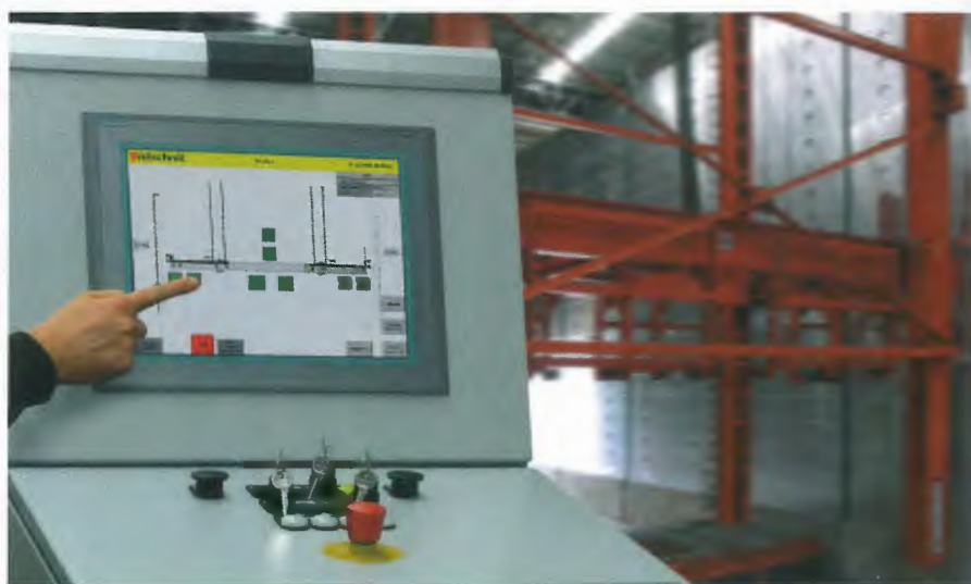
Touchscreen zur Bedienung eines Regalbediengerätes
