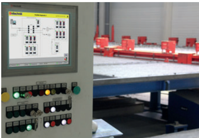
Netzwerk-Diagnose auf der Unitechnik-Steuerstelle
